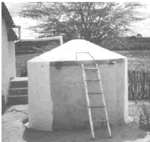
FIGURA 4 - CISTERNA DE CONCRETO COM TELA DE ARAME
